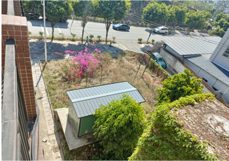
图 3-5 地埋式生化处理系统
