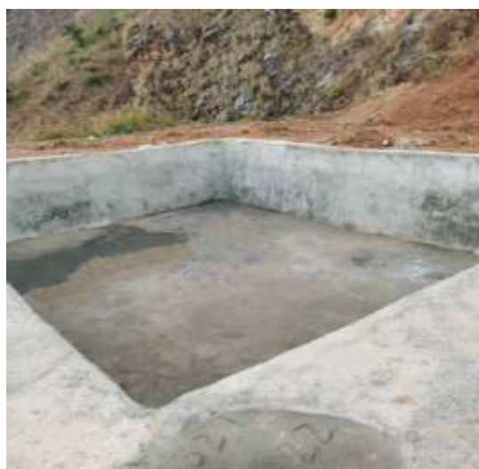
图 4-17 排土场淋溶水收集池
