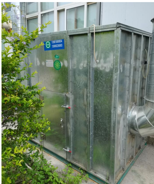
图 3-1 项目布袋除尘器
